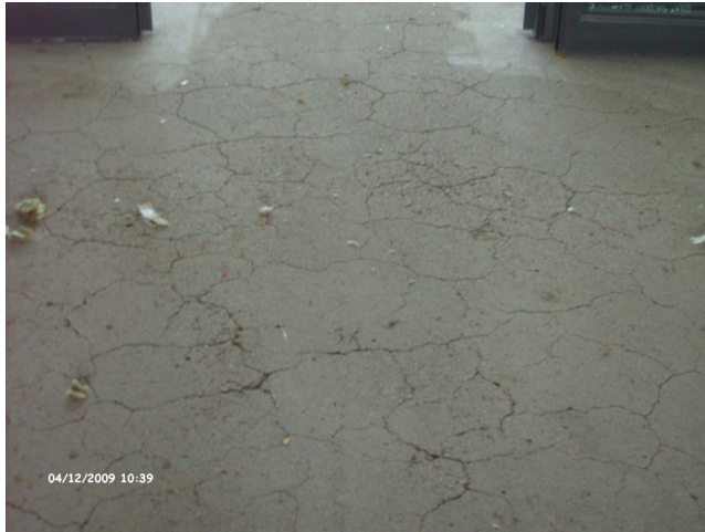
← Bild 2: Netzrisse in einem eingebauten Verbundestrich
