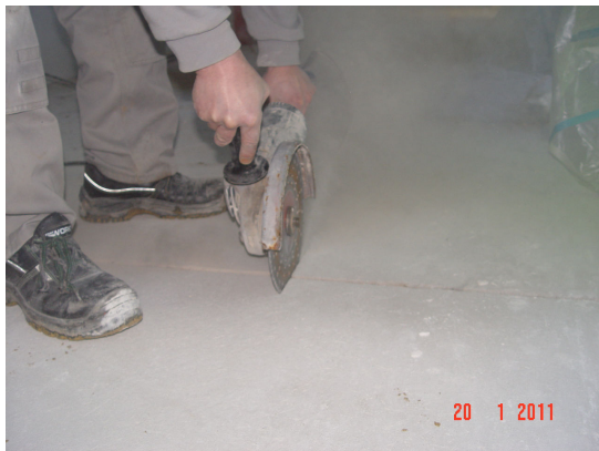
Bild 10: ← Aufschneiden des Risses mit ein Flex bei enormer Staubentwicklung.
