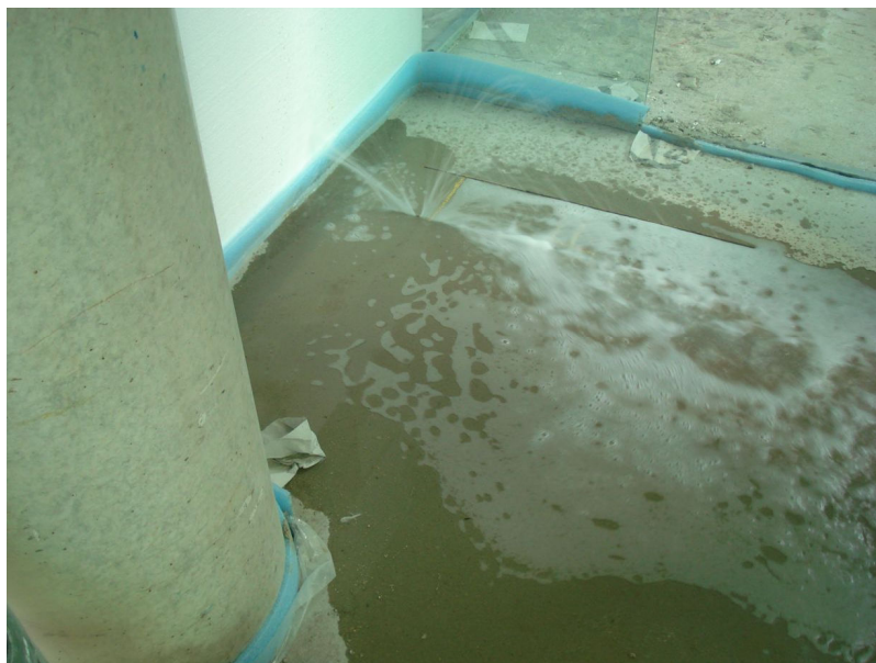
Bild 13 Angeschnittener Heizleiter beim Aufschneiden eines Risses!
