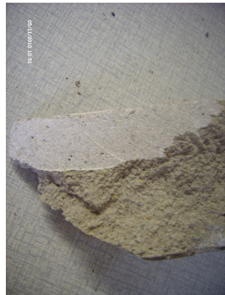
Bild 12: Schnitt in einem Anhydritestrich mit staubgefülltem Porengefüge
